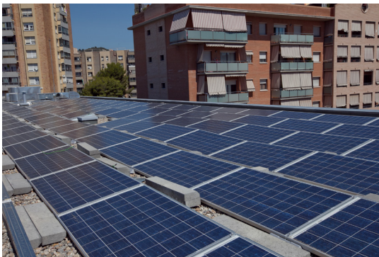
Placas fotovoltaicas instaladas en un edificio rehabilitado gracias al proyecto Vilawatt Fuente: Ayuntamiento de Viladecans
